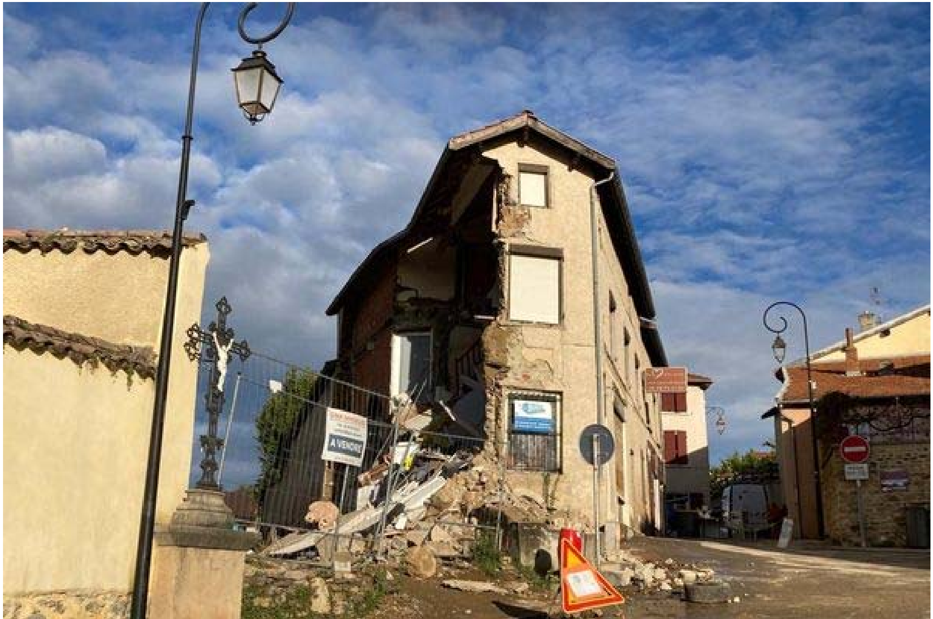
Lyon – Novembre 2022 : Chaponost près de Lyon : un immeuble s'effondre
