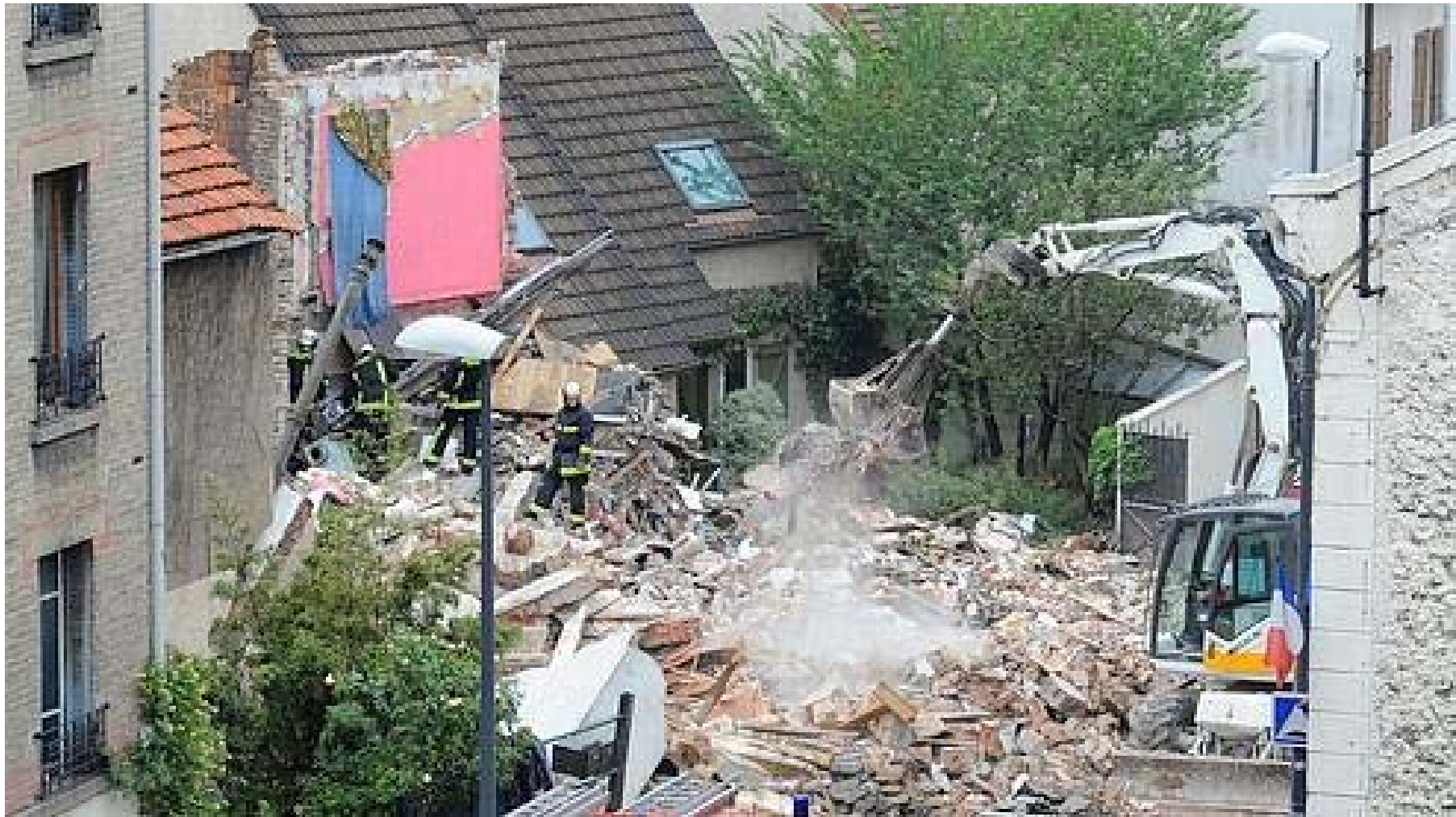
Montreuil - Juin 2011 - Rue Parmentier un hôtel concerné par un arrêté d'insalubrité, s'écroule sur une maison voisine = 3 personnes meurent sous les décombres
