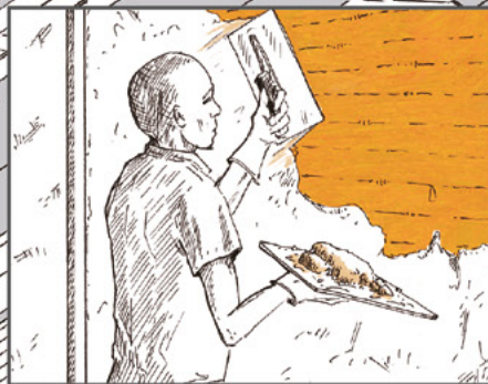
LES MURS SONT ENDUITS À L'ARGILE À L'INTÉRIEUR ET À LA CHAUX À L'EXTÉRIEUR. CHAQUE FINITION EST EN TROIS COUCHES. LA COUCHE D'ACCROCHE (GOBETIS) ENROBE TOTALEMENT LES BRINS DE PAILLE AVEC AU MINIMUM 10 MM DE PÉNÉTRATION. LE CORPS D'ENDUIT TRAMÉ, D'UNE ÉPAISSEUR DE 20 À 30 MM, VISE À RATTRAPER L'APLOMB. L'ENDUIT DE FINITION A UNE ÉPAISSEUR DE 6 À 10 MM ET UN FIXATEUR À LA CASÉINE EST APPLIQUÉ À L'INTÉRIEUR.
